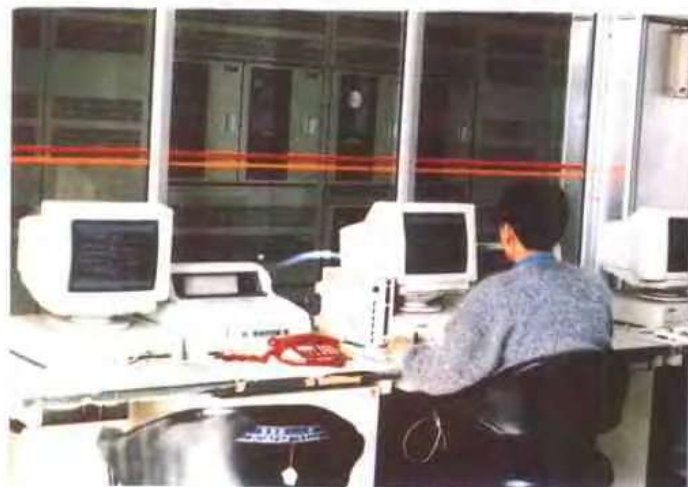
5000 门程控电话机房
