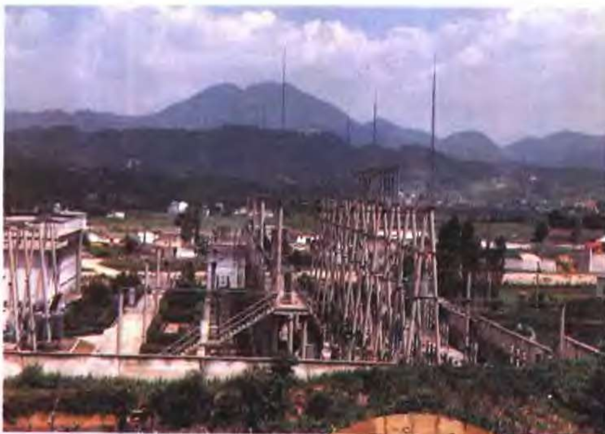
华东电网旌德 11万伏变电站
