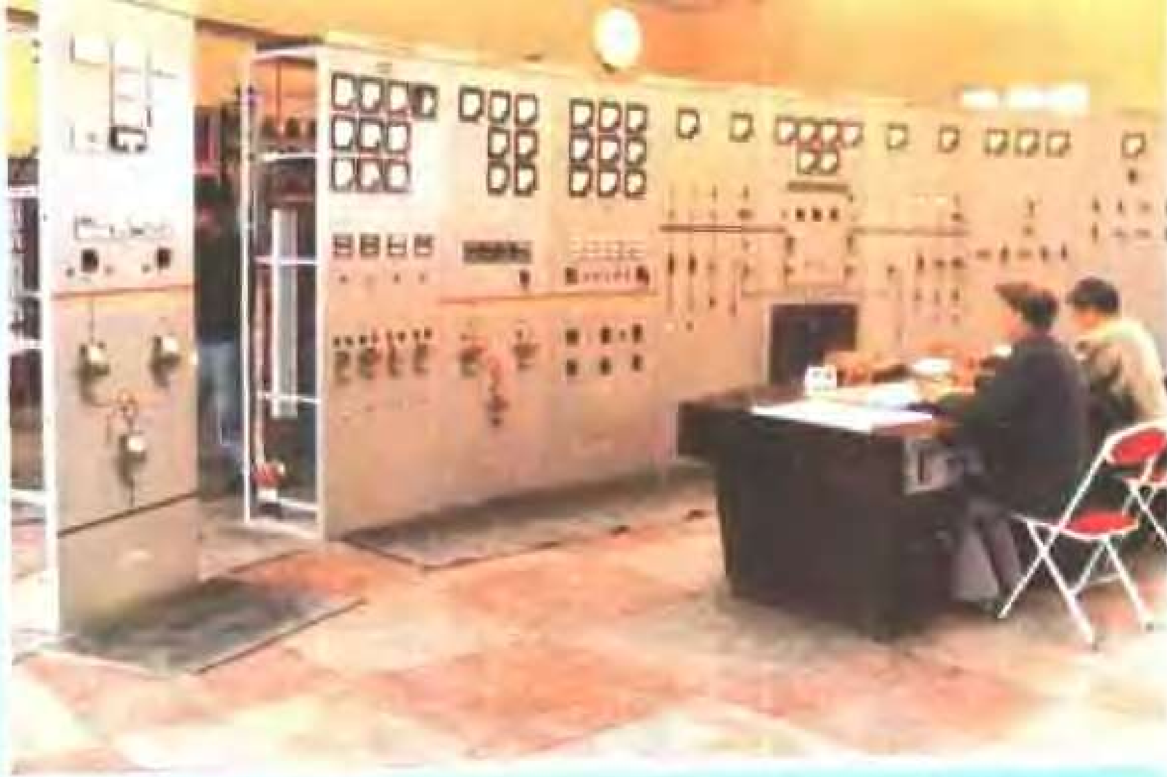
11 万供电所总值班室
