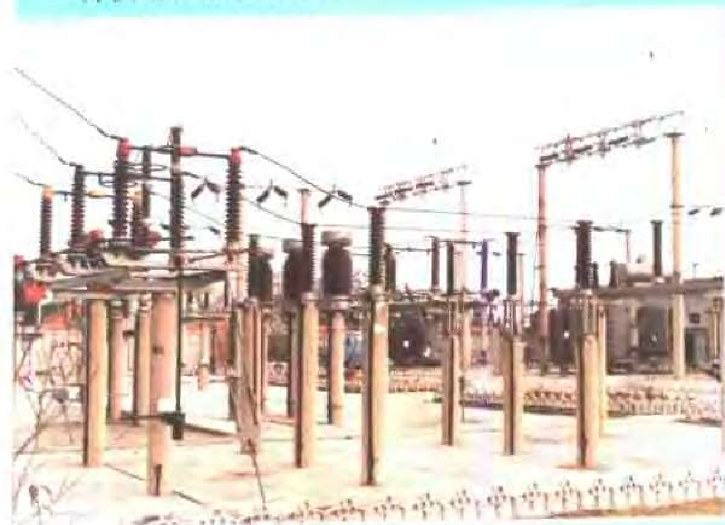
11 万供电所输变电网络
