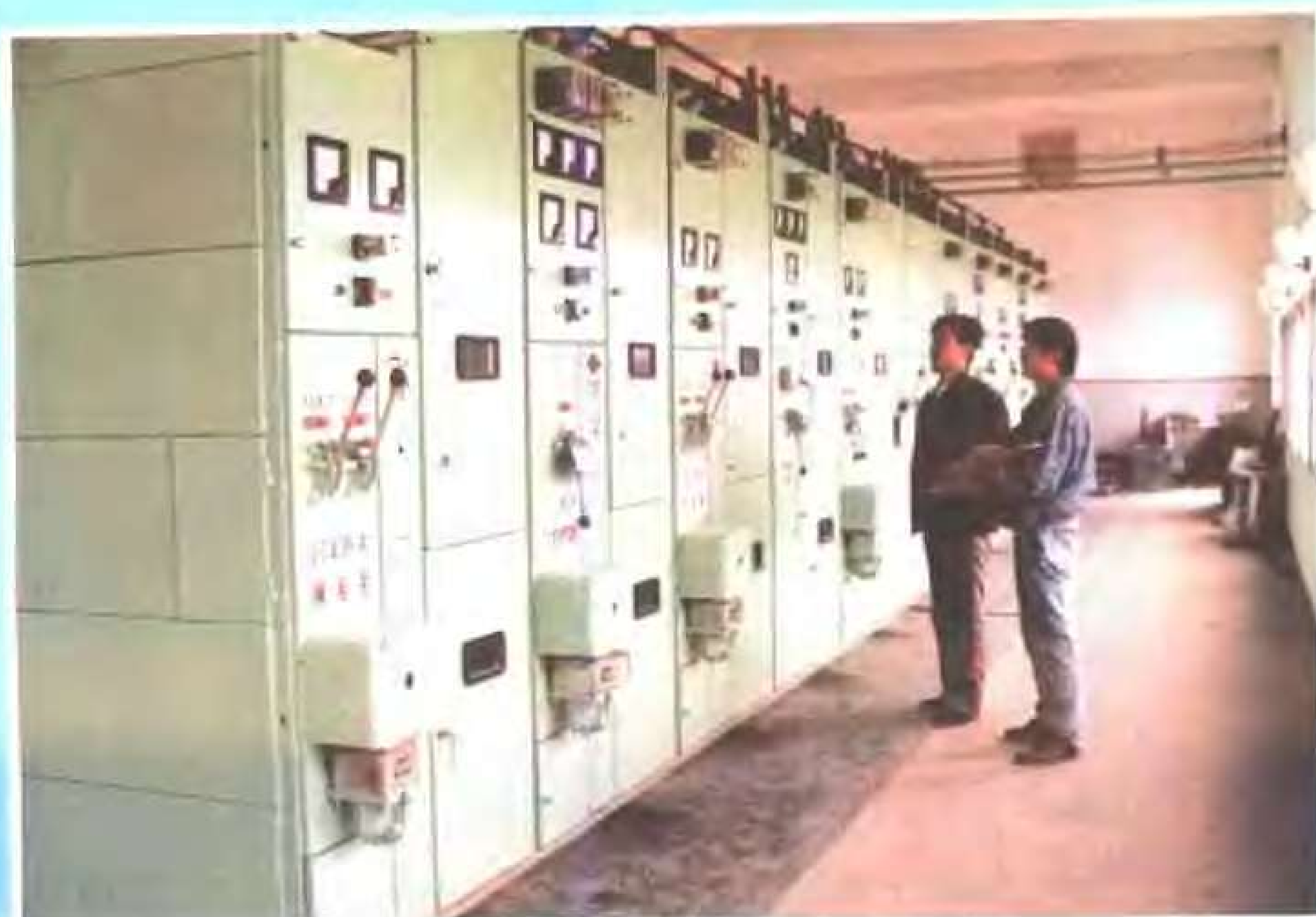
陶厂供电所配电房
