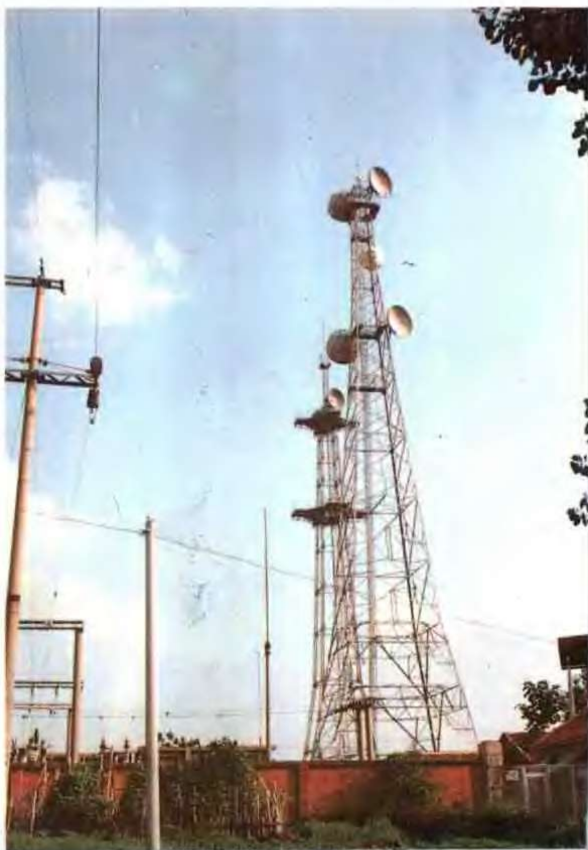
(24) 供电局微波塔
