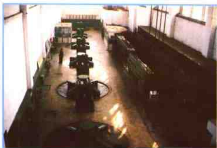
涑口水电站发电机房
