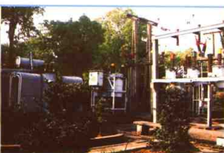
涑口水电站变电升压站
