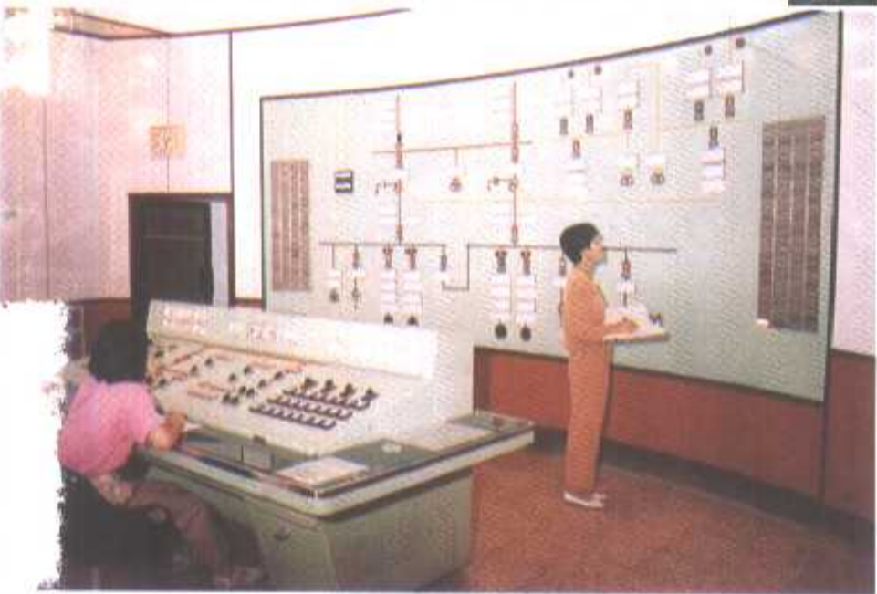
▽ 遙田水電站集中控制室
