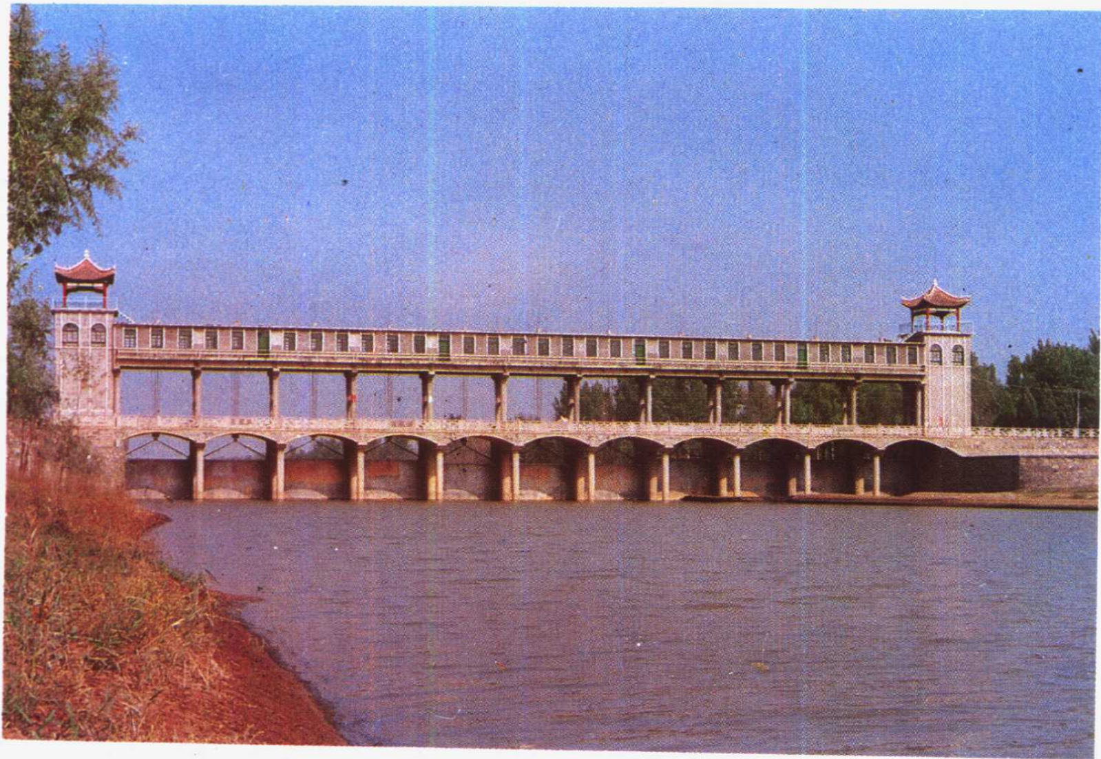
惠济河板桥闸
