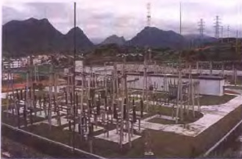
◀ 1988年建成的连南110千伏 输变电站与国家大电网联通
