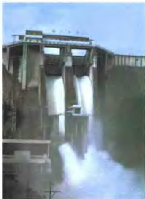
南一水库窄缝消能滞流状况
