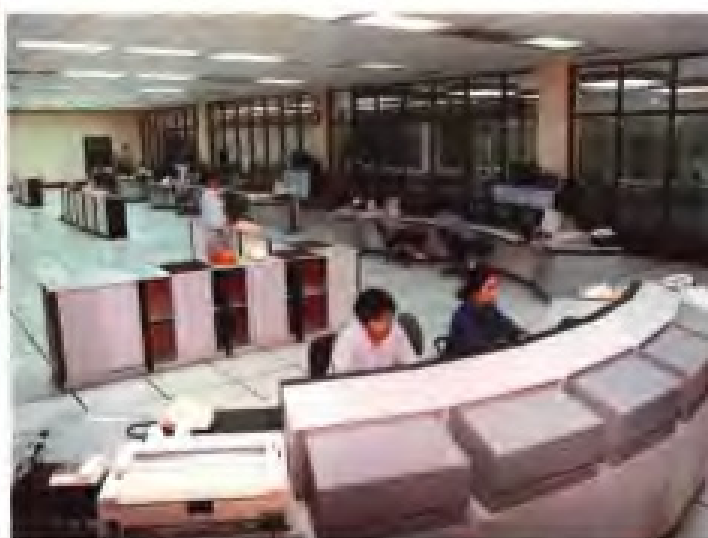
福建炼油厂生产装置中心控制室
