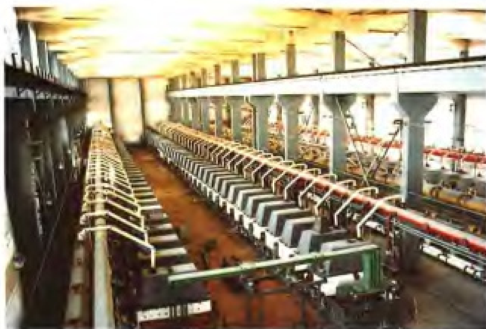
福州第二化工厂烧碱车间金属阳极电解槽
