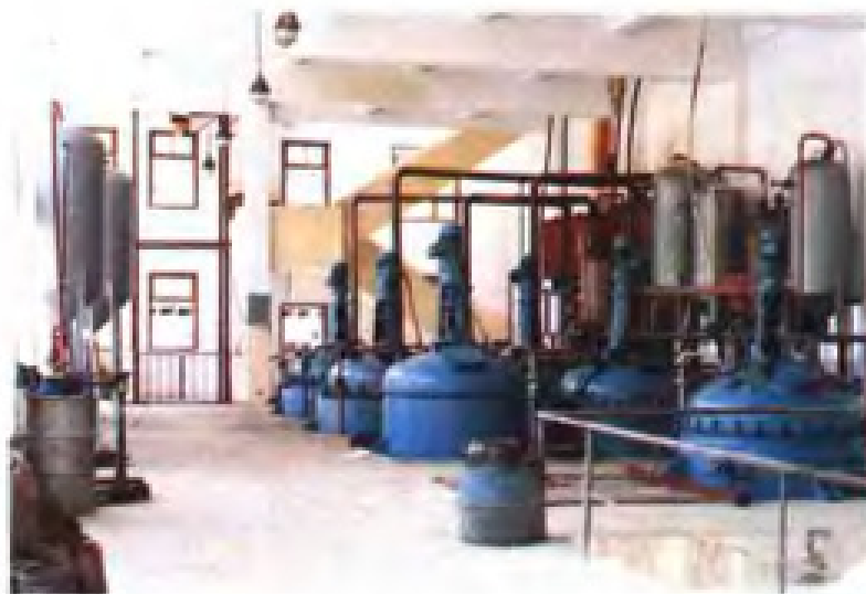
浦城生物化学有限公司发酵罐
