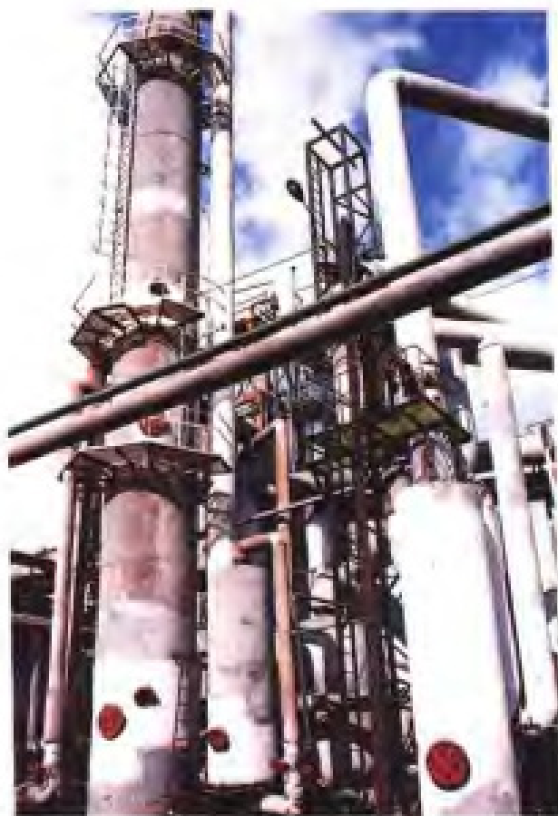
永安智胜化工联合公司合成氨车间一角
