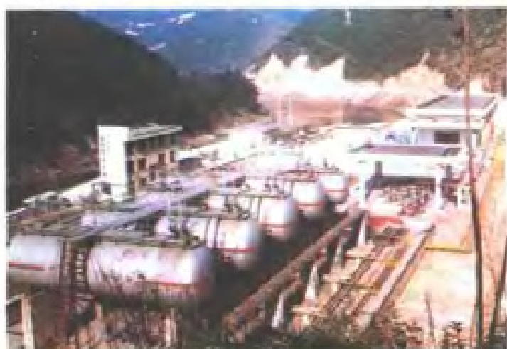
三明液化气贮罐站
