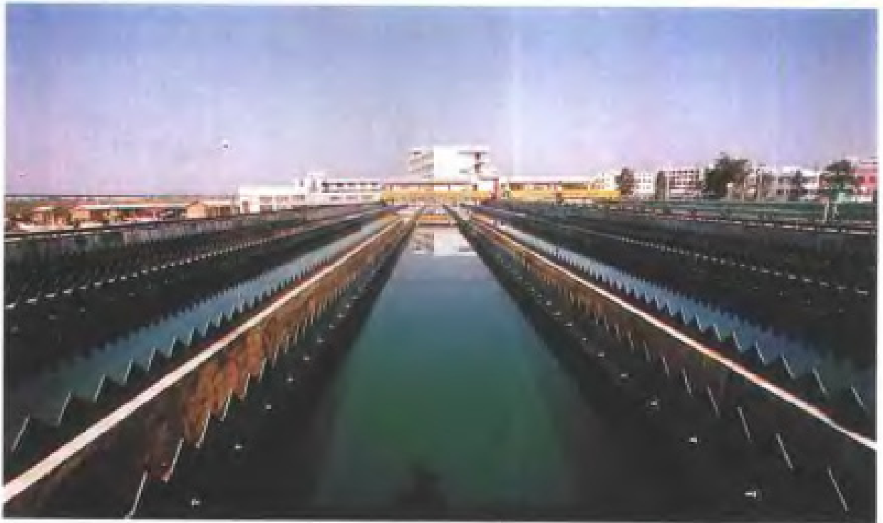
自来水厂滤水池
