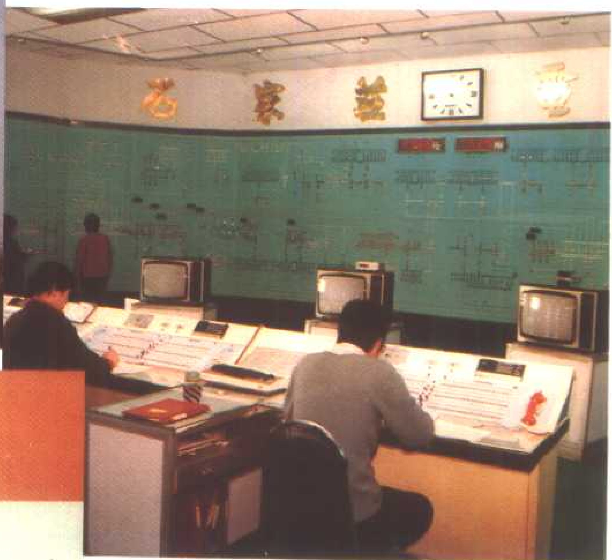
▲石家庄地区电力调度室
