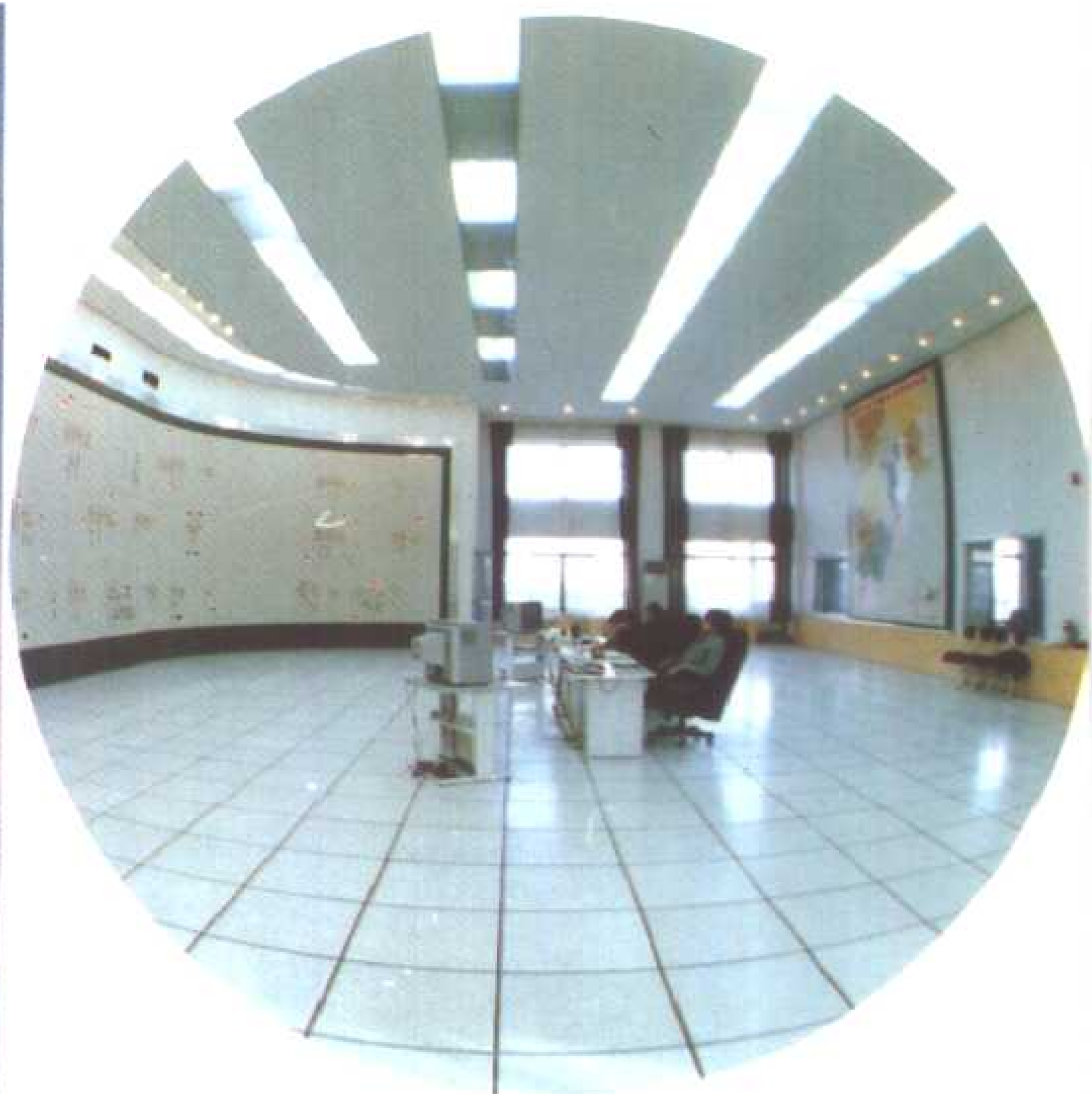
▲省电力调度室
