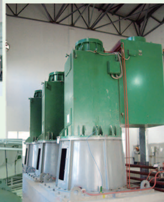
华能威海电厂2×30万kW机组 海水脱硫系统1200VXL海水循环泵
