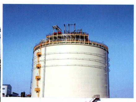
30 000m 3 LNG贮槽
