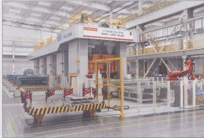
● 由1台LS4—2000H型（配置数控液压拉伸垫）、4台JF39—1000D型闭式四点单动压力机和机器人冲压自动化系统组成的大型自动化冲压生产线（安装在上海汽车集团股份有限公司乘用车分公司）
