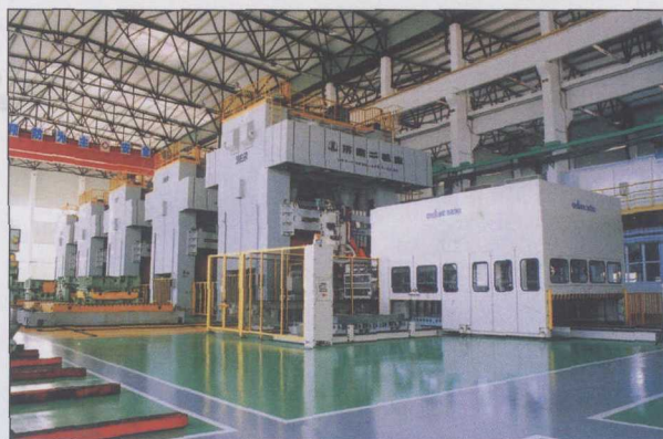
由1台LS4-1600A型、3台JB39-1000D型、1台JA39-800D型封闭式四点单动压力和冲压自动化系统组成的大型自动化冲压生产线(安装在江西昌河铃木汽车有限责任公司)
