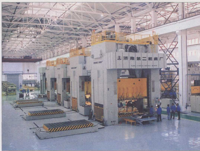
● 由1台LS4—1300型、3台JB39—500型闭式四点单动压力机组成的的大型冲压生产线（安装在南京长安汽车有限公司）。
