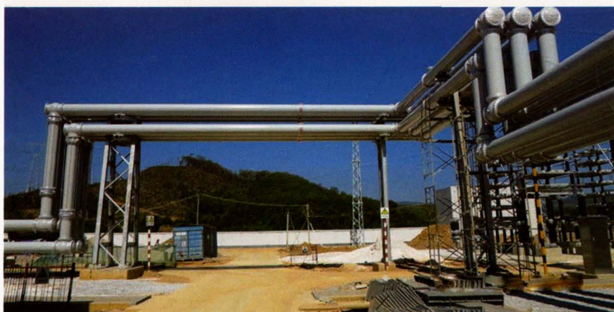
运行在云南糯扎渡 普洱换流站 550kV GIL
