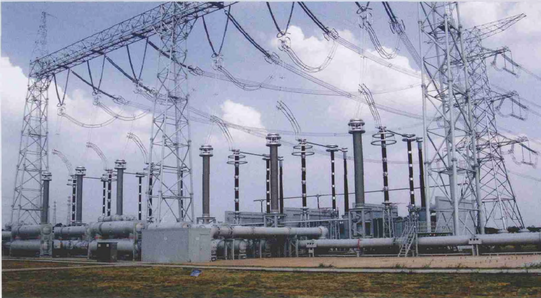
百万伏产品在皖南变现场运行
