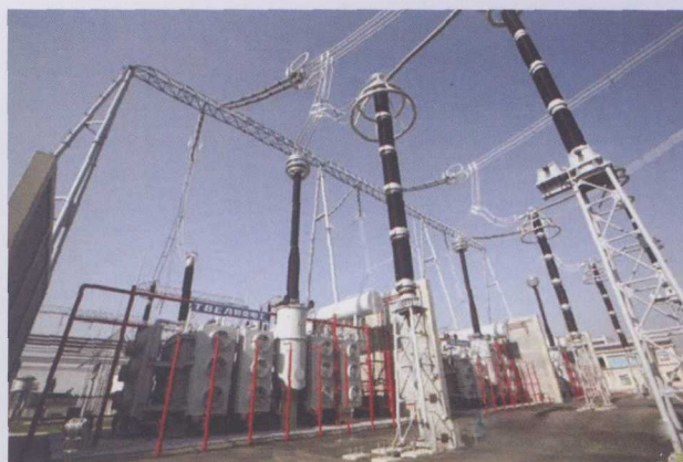
特高压线路晋东南—南阳—荆门特高压交流试验示范工程
