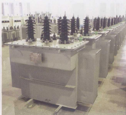
油浸式双电压配电变压器
