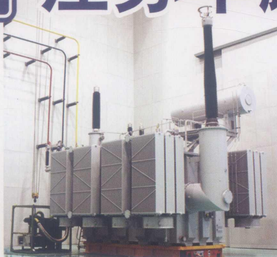
500kV级变压器
