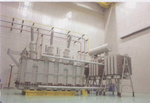
出口加拿大400MV·A/230kV自耦变压器
