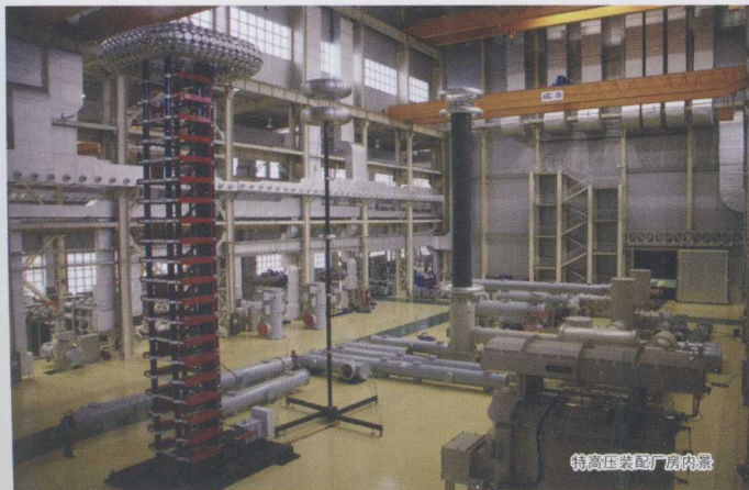
ZF27-1100 GIS投入商业运行的特高压线路晋东南变电站
