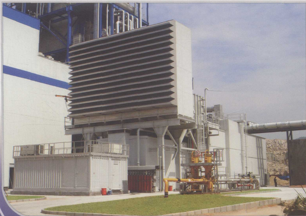
安装在深圳美视电厂9E燃气轮机
