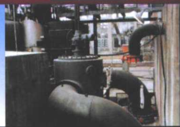
正在运行中的自动反冲洗滤网装置
