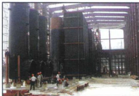
北京巴·威公司与芬兰公司合作生产的116MW燃气热水炉双榆树供热厂安装现场
