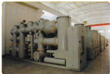
ZF6-110 型 SF6 封闭组合电器 (GIS) 在北京西客站运行
