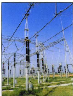
GW6-500 型高压隔离开关在北京供电局运行
