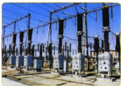
LW11-220 型 SF6 瓷柱式断路器在上海闵南变电站运行
