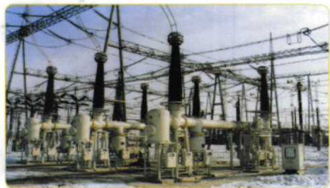
ZF6-500 型 SF6 封闭组合电器 (GIS) 在辽阳500KV变电站运行
