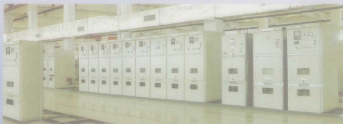
▲ 中压开关柜装配车间
