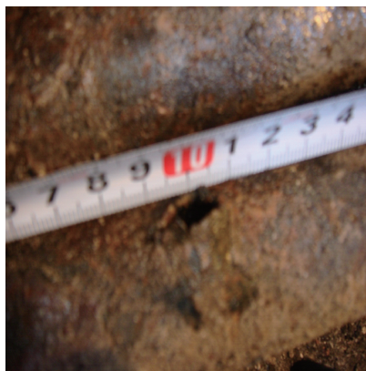
图 1-1 望城菱格木业有机热载体炉泄漏盘管
