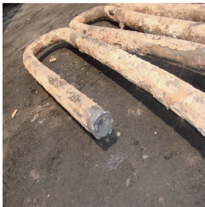
图 1-2 郴州有机热载体炉事故积炭管
