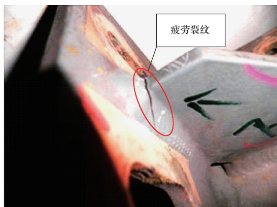
图 1-1 舱裙板支架焊缝疲劳开裂
