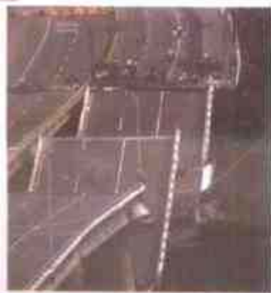
我国台湾省台北市发生里氏7.6级地震，导致人员伤亡，房屋被毁，图为被摧毁的桥梁
