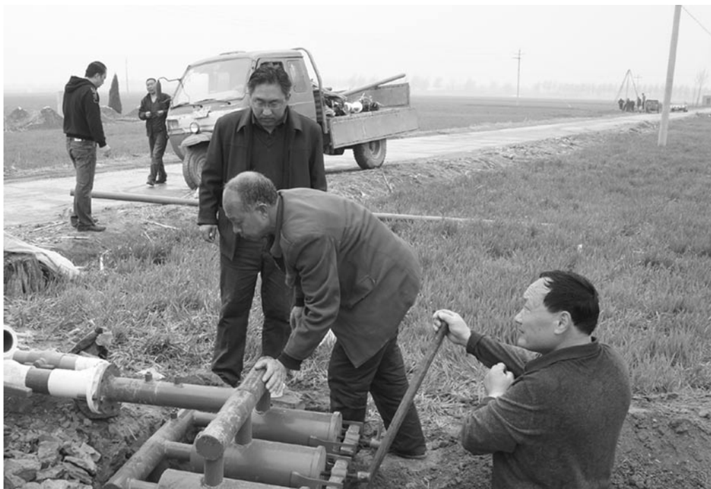
基层建设年活动工作组帮扶南营村的喷灌设备正在进行安装施工
