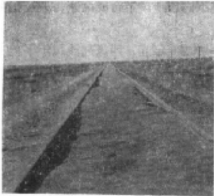
照片1 风沙埋道,威胁行车安全 (1967年4月摄)
