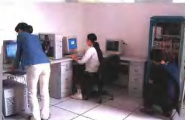
网络中心机房
