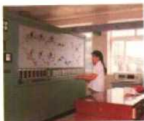
▽ 制盐三厂主控室
