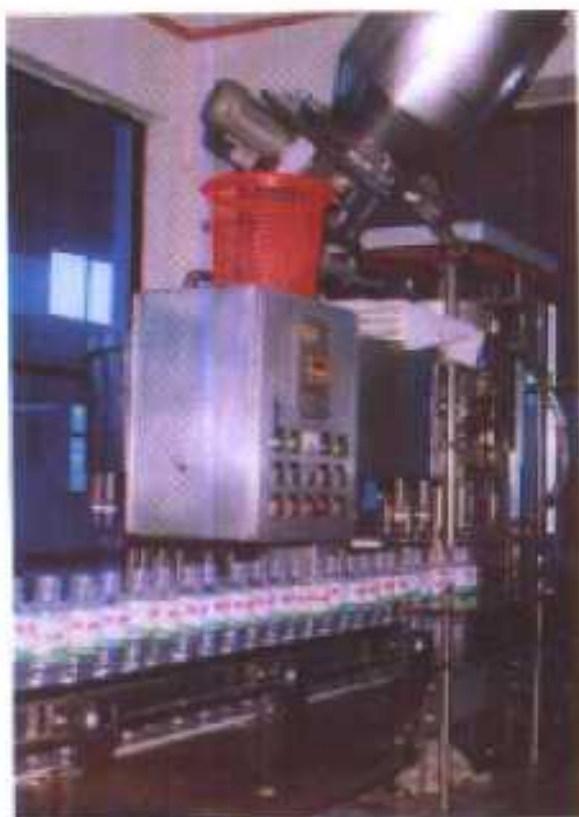
湖北省孝感市水神饮品有限公司恒源矿泉水自动生产流水线(小河镇)
