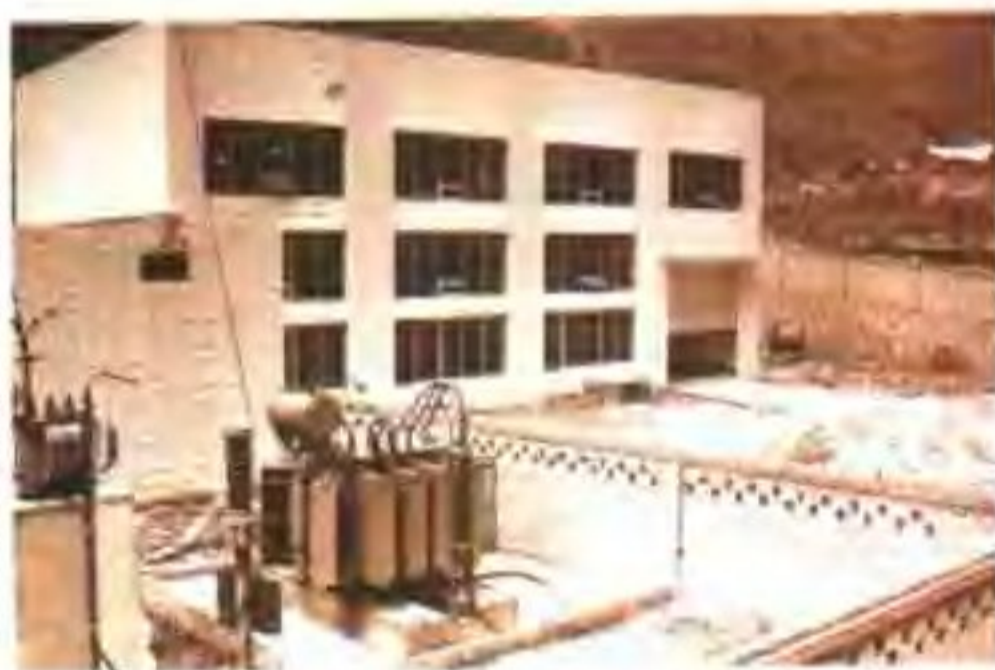
刚建成的七盘沟电站生 产区一角
