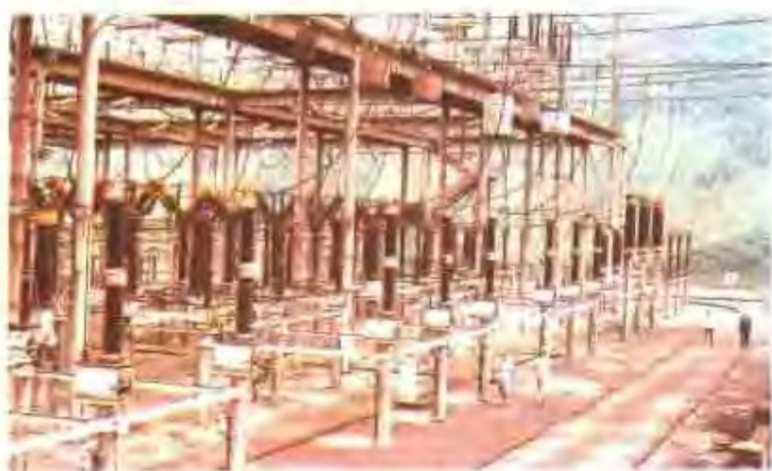
映秀湾二台山220千伏联合开关站
