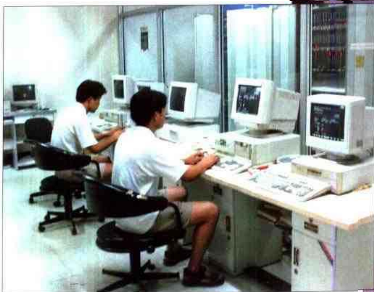
20000门程控电话机房
