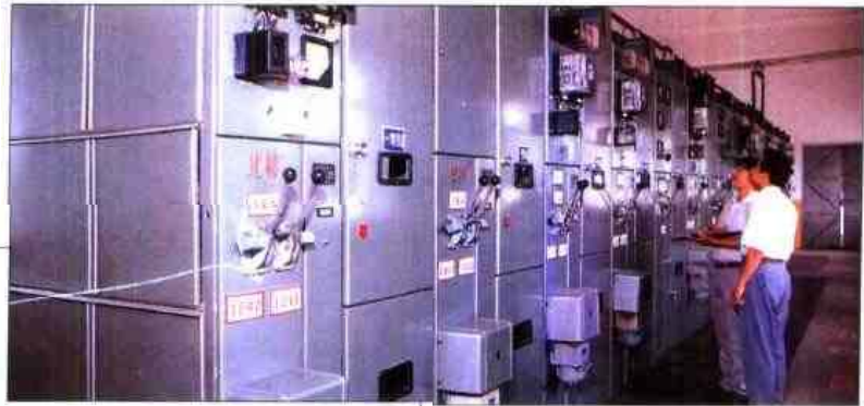
山区变电所控制室
