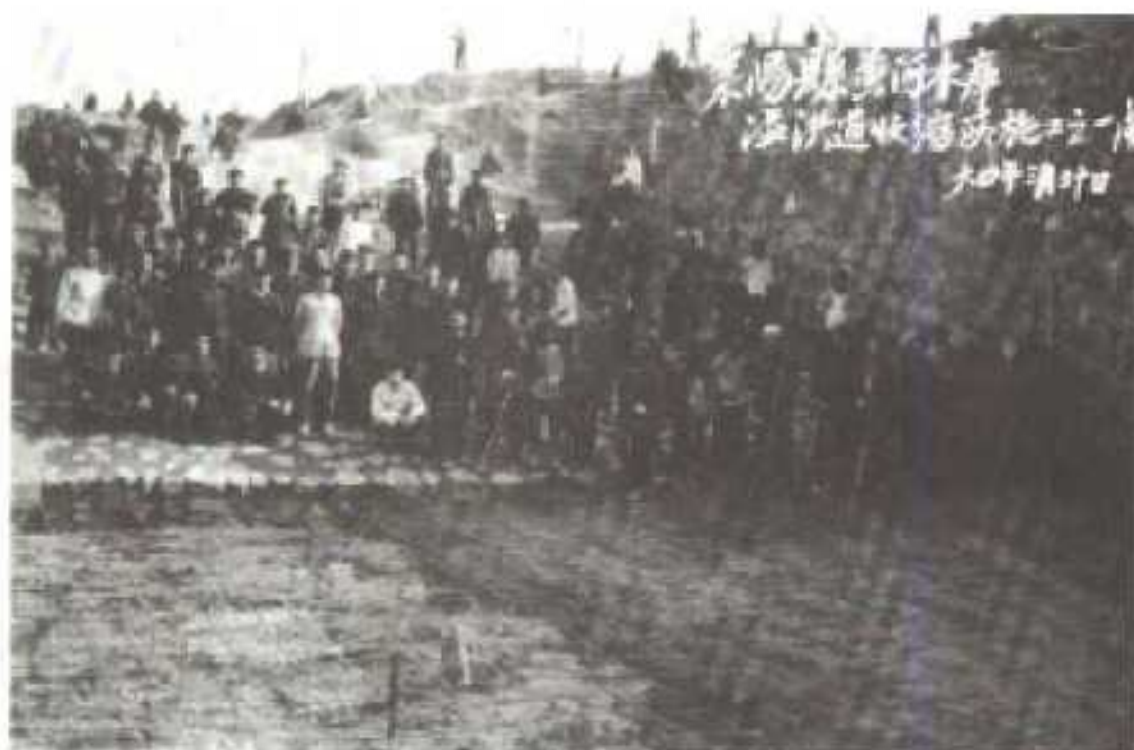
一九六四年枣阳县中型水库——小黄河水库溢洪道收缩段施工一角。
