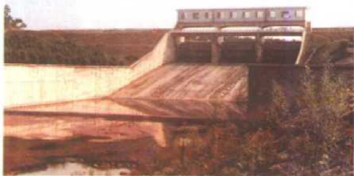
熊河大型水库溢洪道弧形闸门。
