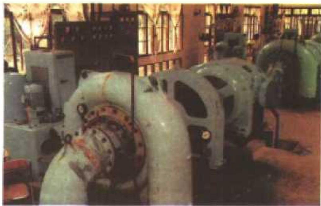
图为：仁化县长江镇甘溪岭电站发电机组
