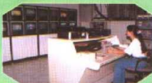
▲ 有线电视台播出机房
