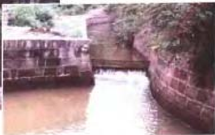
青柯壩电站前池
