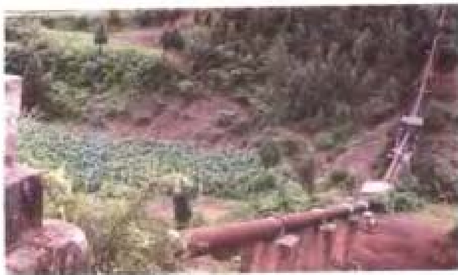
白垆子支渠倒虹管
