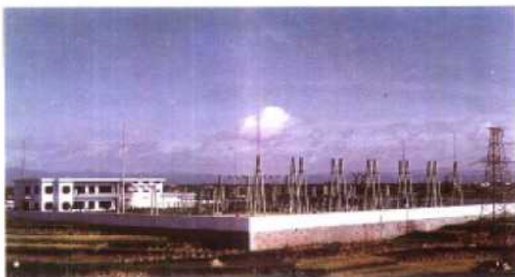
罗城城东 110 千伏输变电站 变电容量 3.15 万千伏安。
