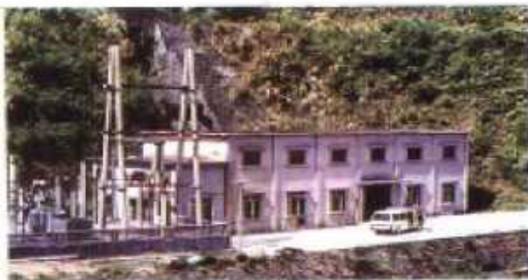
海關水庫觀音亭 於此設置之變壓器，中心 電壓為三千伏特
