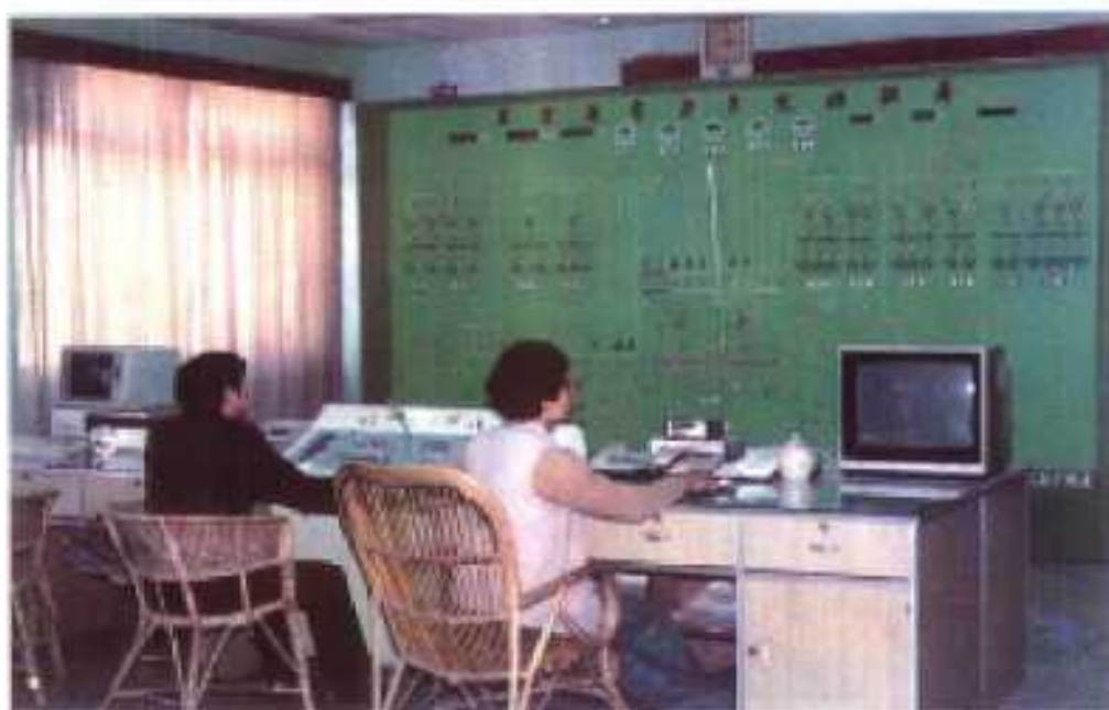
市供电调度中心 采用微机优化调度,使全市 供电安全、合理、经济。
