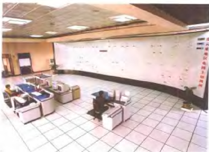
连云港地区电网调度室
