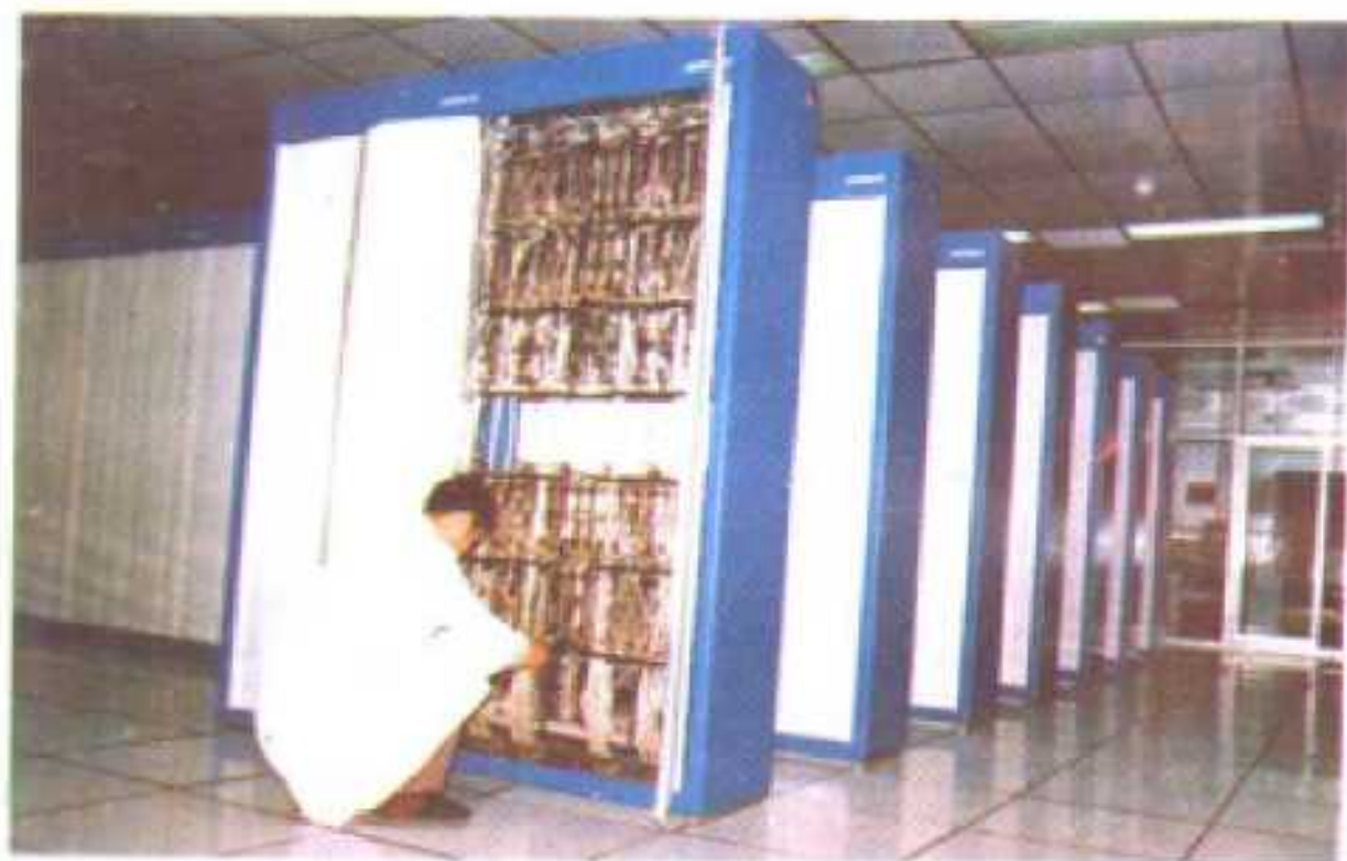
电信程控机房
