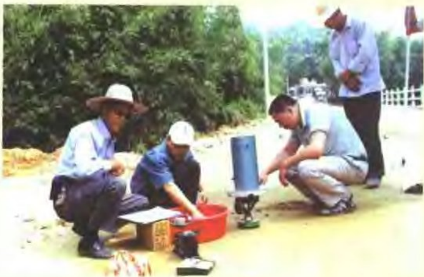
2001年8月， 珠木线公路改 造，公路建设 指挥部质监组 会同施工队检 测基层压实度。
