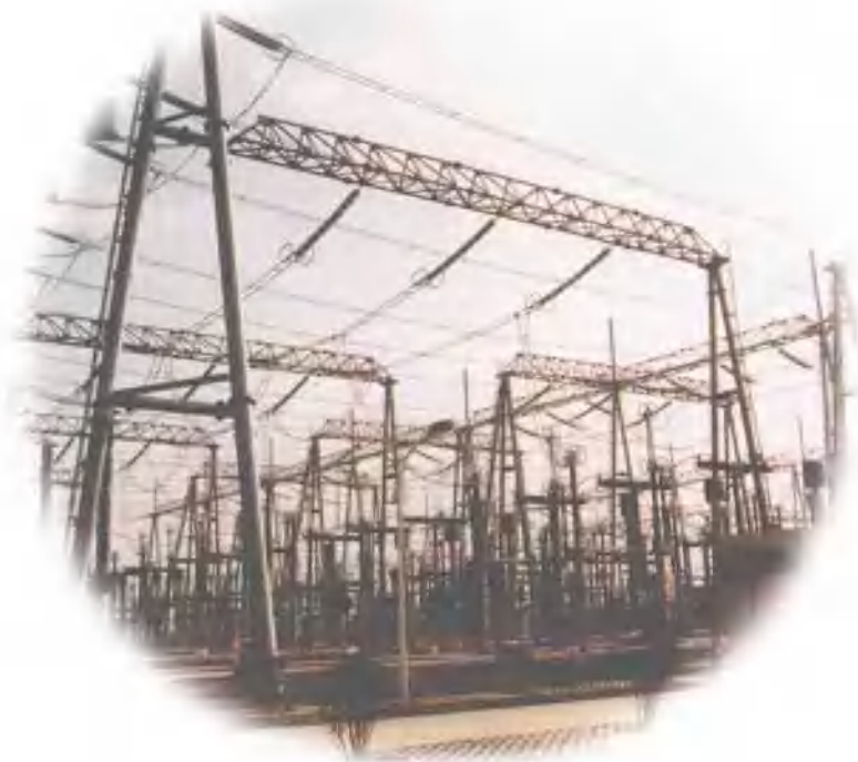
2003年投入运行的500千伏变电站
