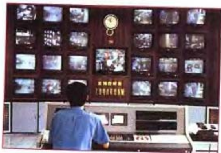
电视监控管理室
