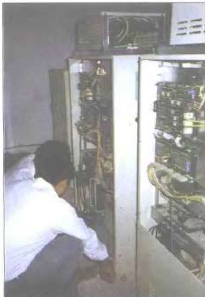
安徽省劳动保护安全卫生检测中心工作人员 在合肥市汉源大厦机房检测电梯控制屏
