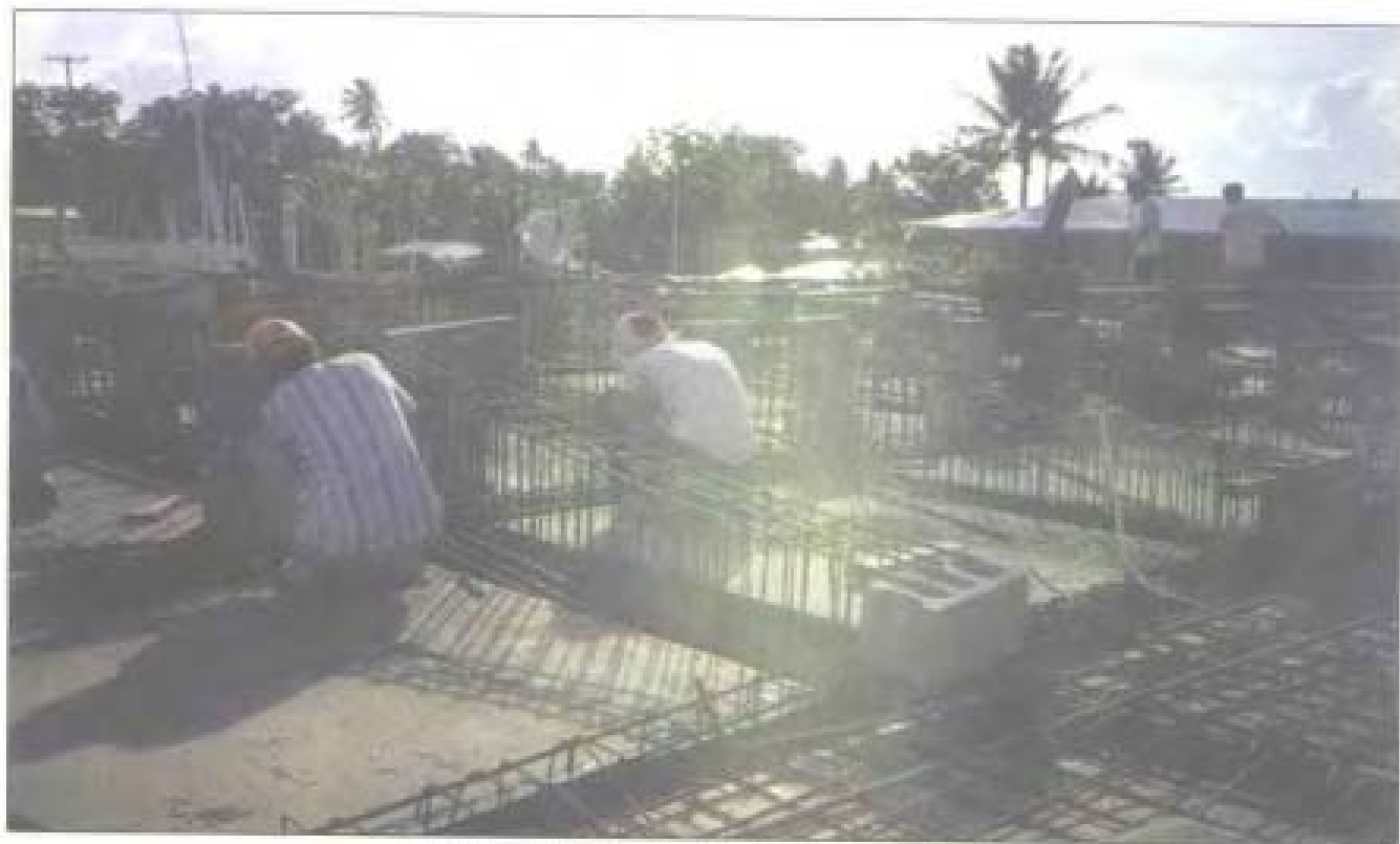
安徽省建筑工程总公司农民合同制工人在合肥工地施工
