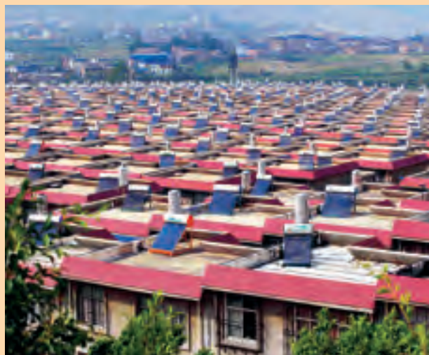
开远市小龙潭新龙社区，家家户户安装了太阳能热水器
