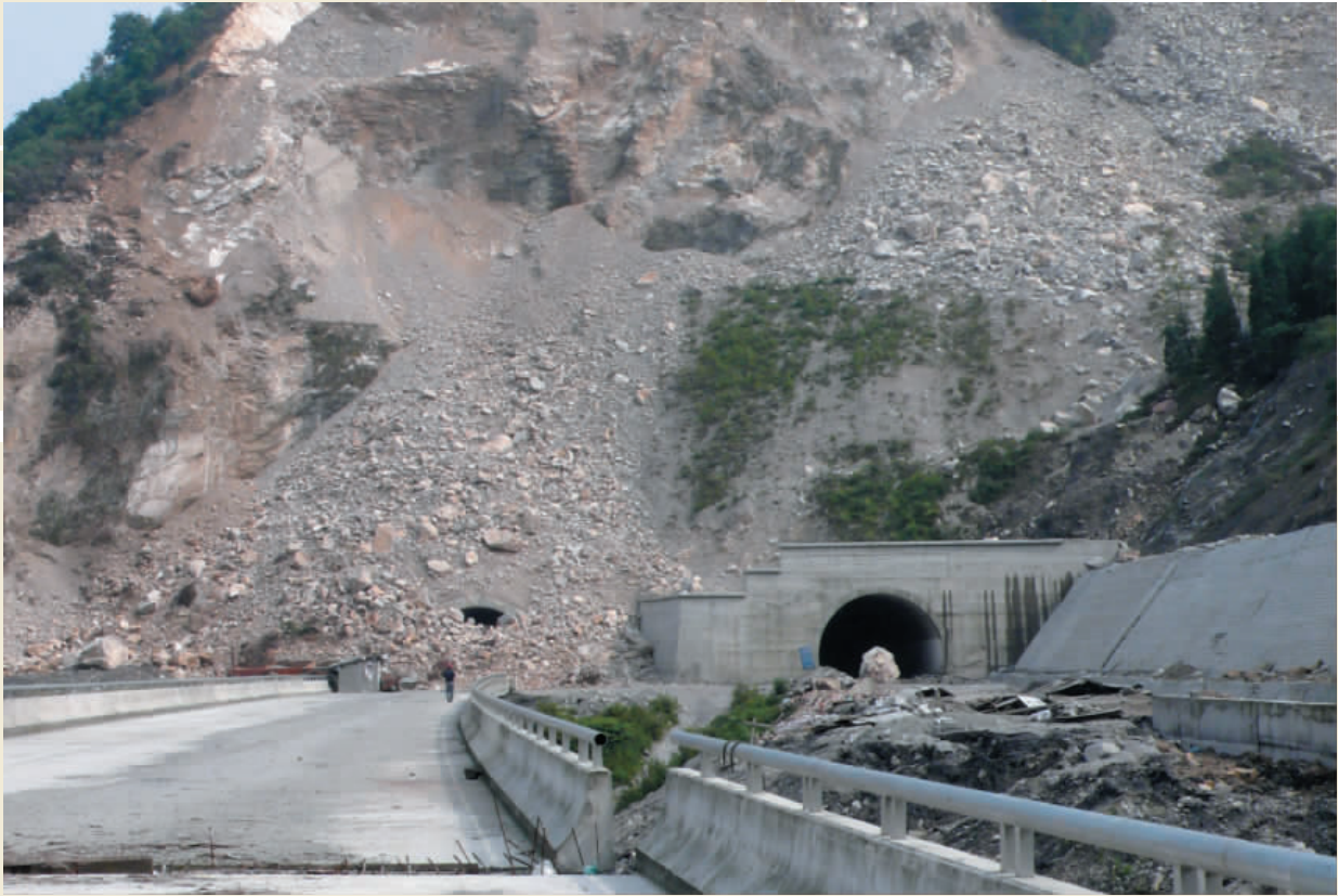
都映高速公路龙洞子隧道出口(震后)
