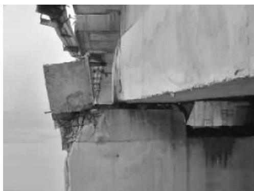
图 7 3# 墩 T 梁挡块损坏
