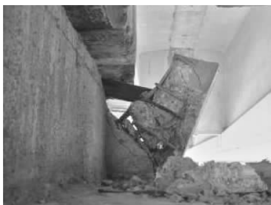
图 9 6# 墩下游侧挡块损坏
