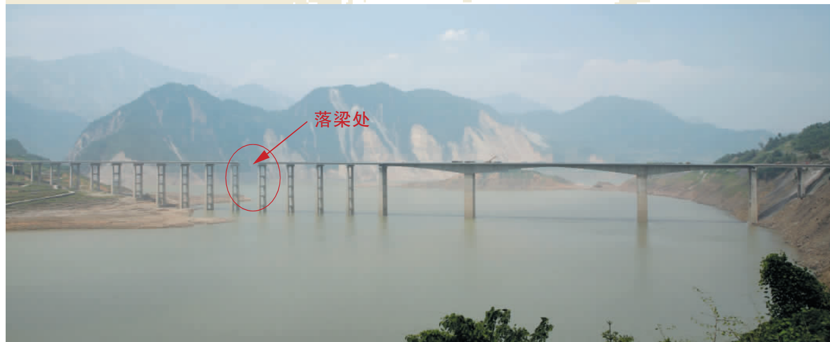
都映高速公路庙子坪特大桥(震后)
