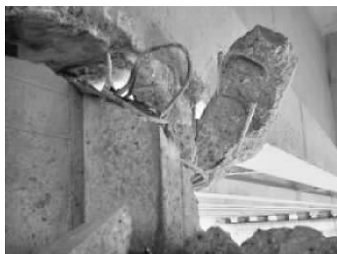
图 8 6# 墩上游侧挡块损坏
